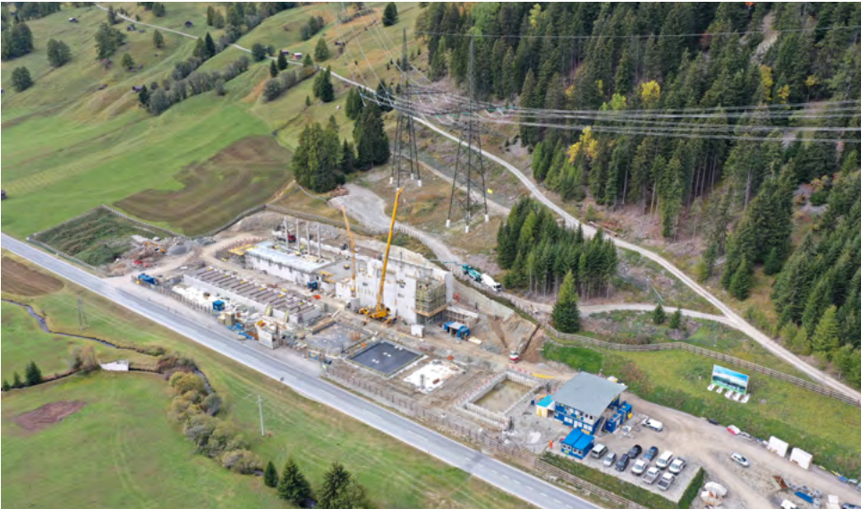
Vom neuen Umspannwerk von APG in Nauders in Tirol verläuft künftig eine Verbindungsleitung nach Italien.
