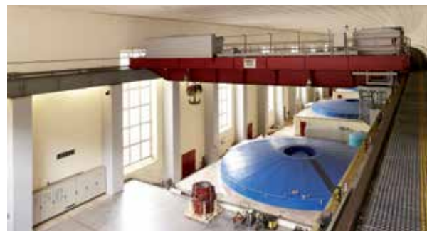
Blick in die Kraftwerkshalle
