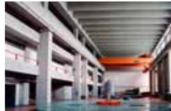
Kraftwerk Ferlach-Maria Rain, Maschinenhalle
