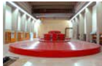
Kraftwerk Edling, Maschinenhalle
