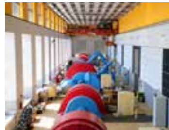
Kraftstation Kolbnitz, Maschinenhalle
