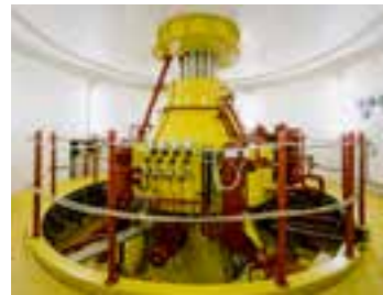
Kraftwerk Kellerberg, Turbinen-Ringraum
