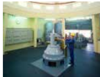
Kraftwerk Lavamünd, Maschinenhalle
