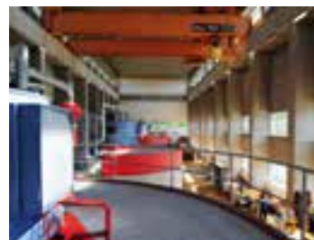
Kraftstation Rottau, Maschinenhalle
