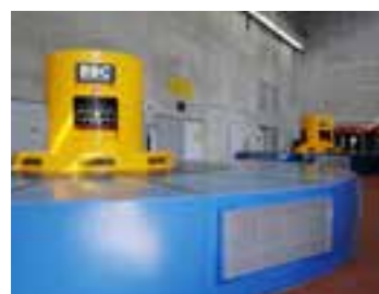
Kraftstation Galgenbichl, Maschinenhalle
