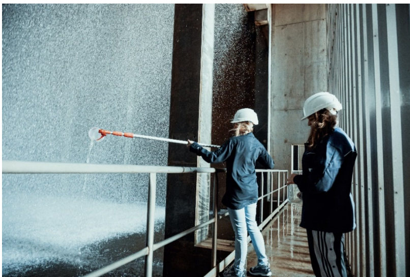
Abb. 11: Beprobung des Kühlwassers in der Kühlturmanlage der Linie 20
