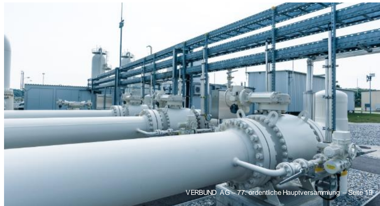
Arbeiten an der 380-kV-Salzburgleitung (Bild oben) und GCA-TAG Gasdrehzscheibe Baumgarten (Bild unten)
