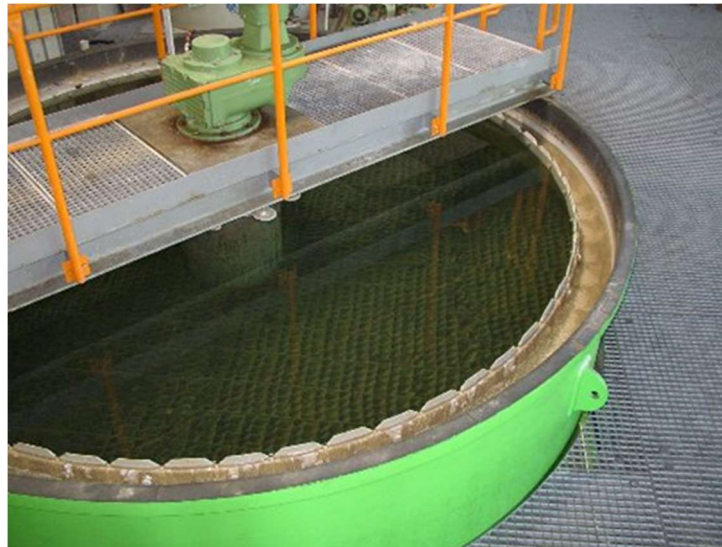
Abbildung 4: Lamellenklärer in der ARA
